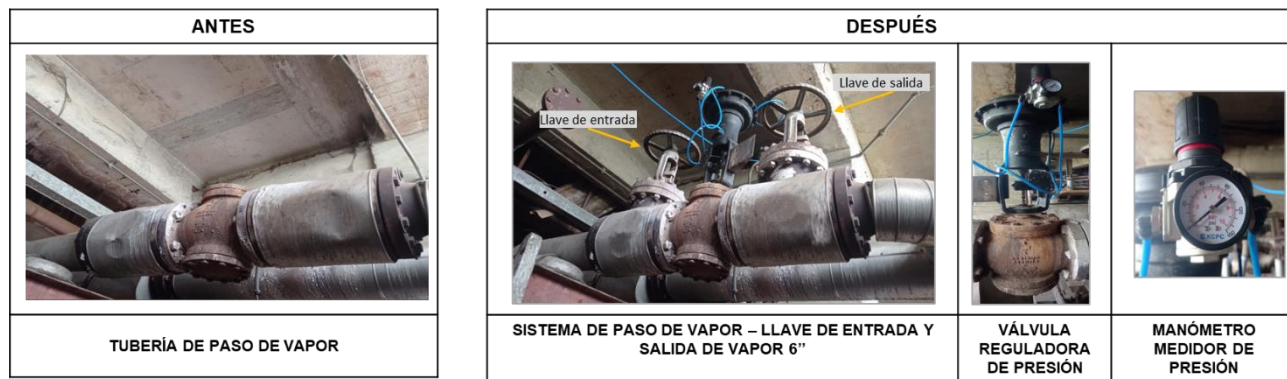
Figura 24 Implementación de válvula de vapor
