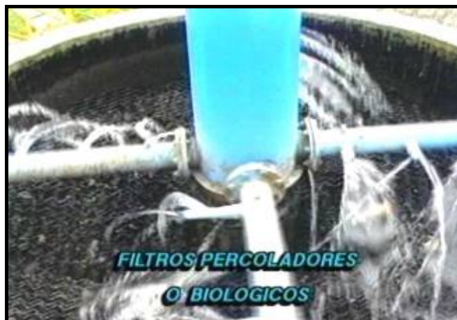
Figura 1.14 Tratamiento secundario: Filtros Percoladores Biológicos (26) .
