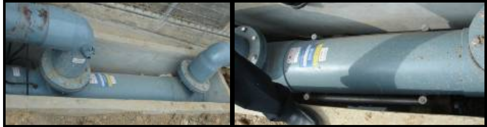
Figura 1.8 Unidad de desinfección de Rayos Ultra Violeta instalada en el Sistema de Tratamiento de Aguas Residuales de la Urbanización Ciudad Celeste (18) .
