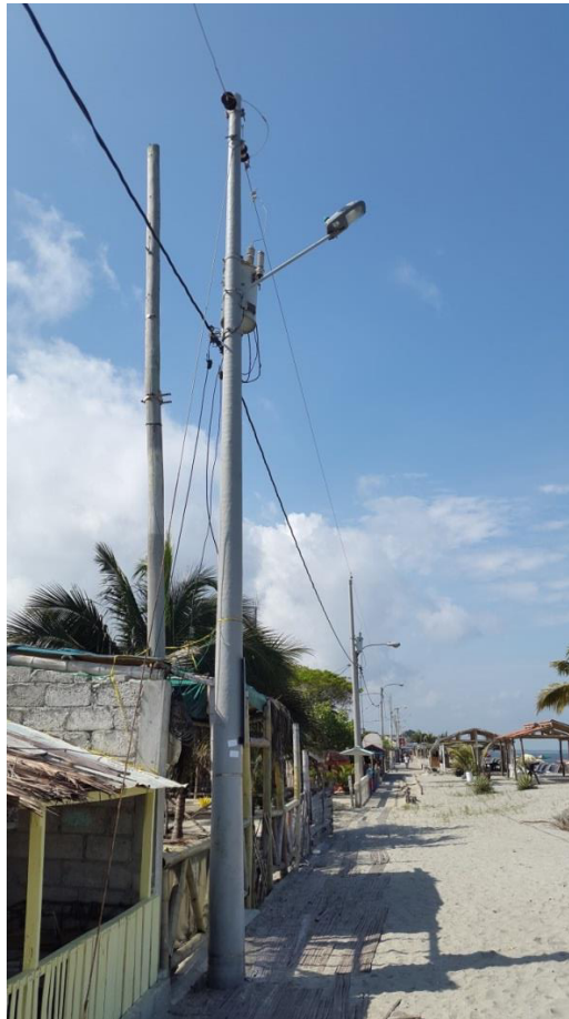
Ilustración 25. Distribución de energía eléctrica en Jambelí.
