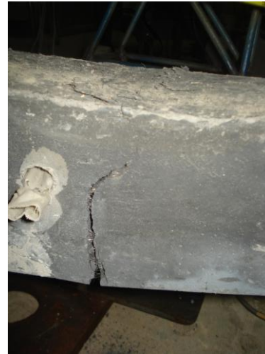
Figura 10. Detalle de fisura en la zona de falla de la viga construida con HAD (vista posterior).
