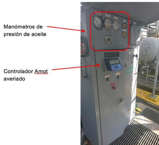
Figura 1.3 Parte Frontal del Tablero de Control [Autor]
