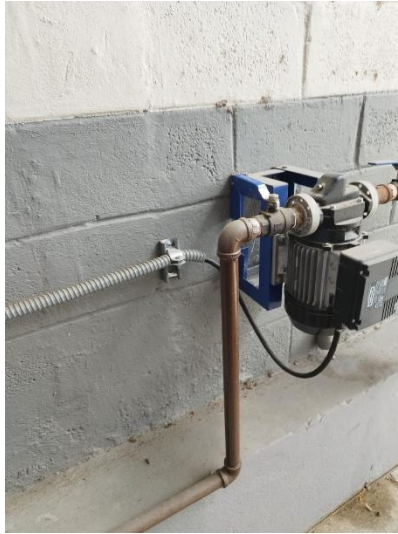
Ilustración 3.30 Registro de bomba
