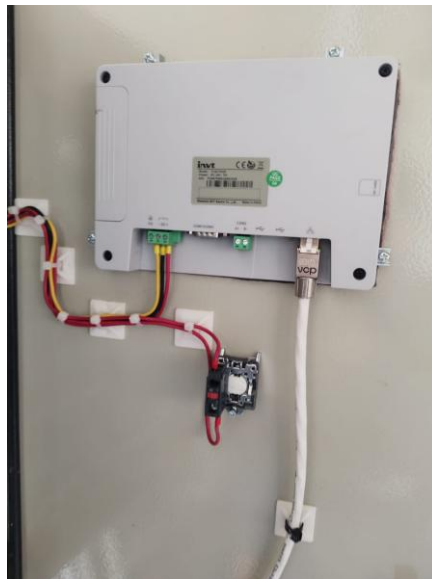
Ilustración 3.33 Panel de control (puerta)
