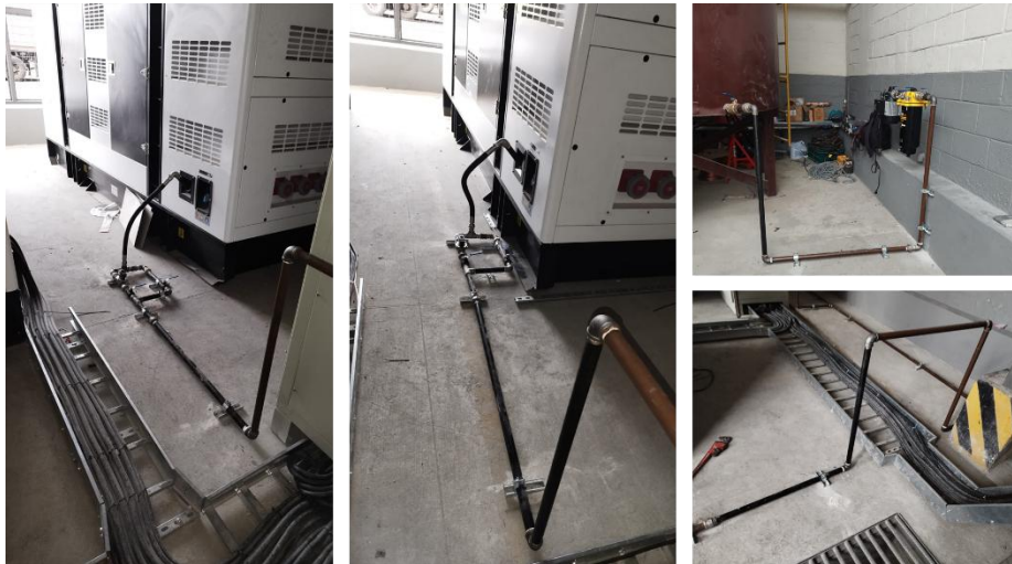
Ilustración 3.28 Tuberías, filtros y actuadores
