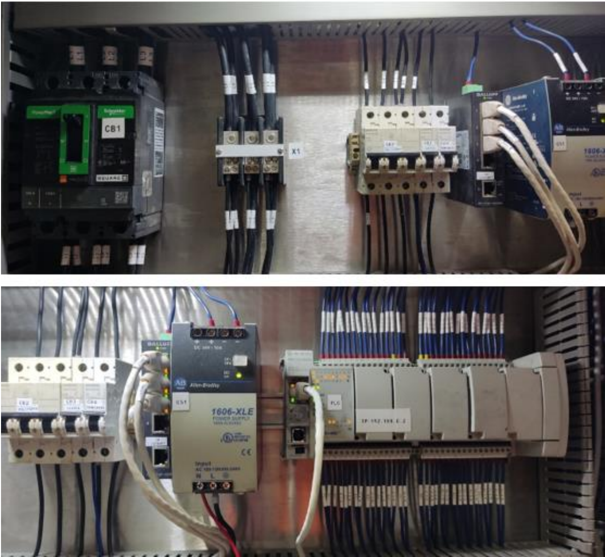
Figura 56. Conexiones EtherNet/IP centralizadas en el switch y a la derecha el PLC Micro 850.
