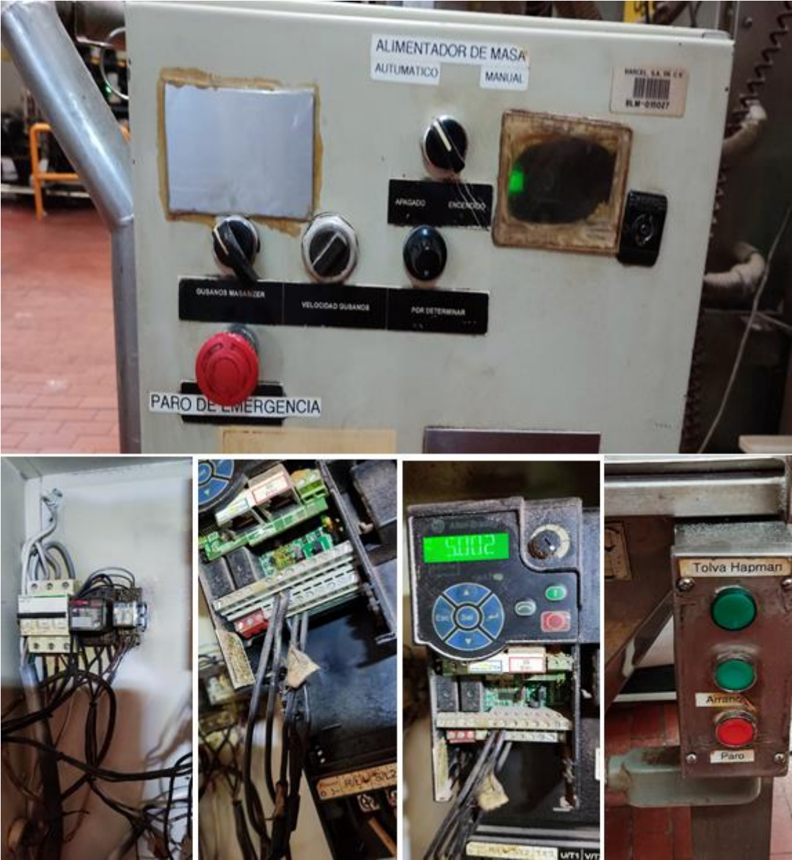
Figura 32. VDF de los rodillos extrusores controlado mediante entradas y salidas cableadas
