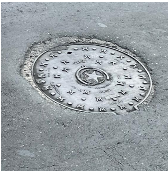
Figura 94. Tapa de Cámara de Inspección B9 Desnivel de la tapa alrededor de la capa de rodadura asfáltica
