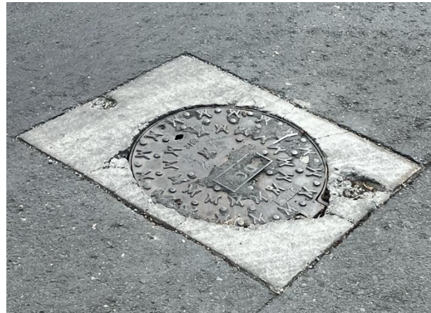
Figura 97. Tapa de Cámara de Inspección B12 Desnivel en la loseta de concreto y fisuras alrededor de la tapa.
