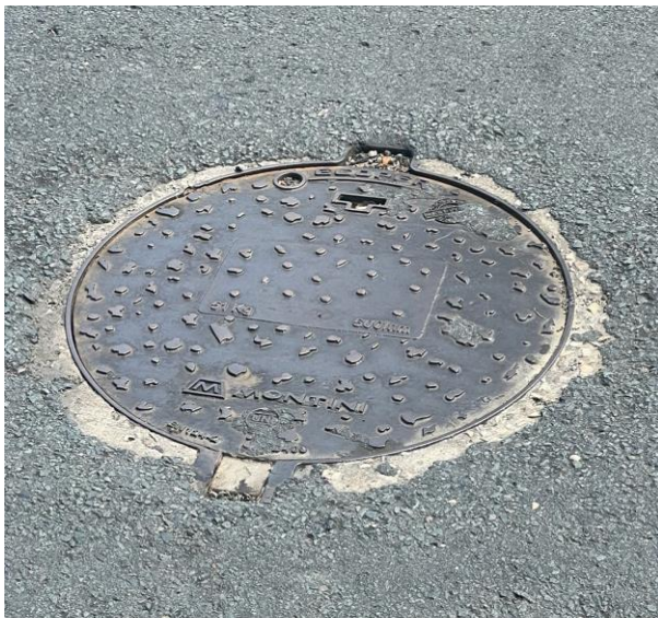
Figura 82. Tapa de Cámara de Inspección A63 Desnivel de la tapa alrededor de la capa de rodadura asfáltica
