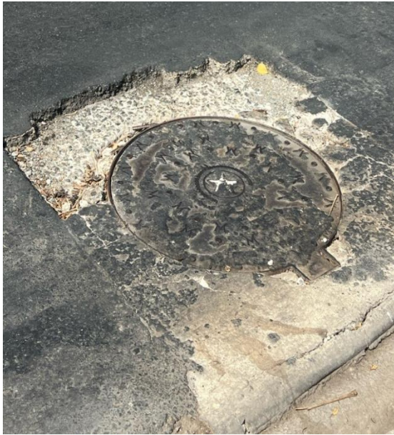
Figura 80. Tapa de Cámara de Inspección A61 Desnivel alrededor de la tapa y pérdida de la carpeta asfáltica en fragmentos.
