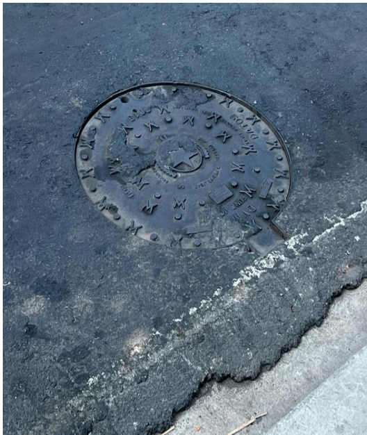
Figura 36. Tapa de Cámara de Inspección A17 Desnivel de la tapa alrededor de la capa de rodadura asfáltica
