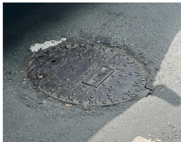
Figura 87. Tapa de Cámara de Inspección B2
