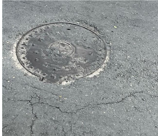
Figura 95. Tapa de Cámara de Inspección B10 Desnivel de la tapa alrededor de la capa de rodadura asfáltica
