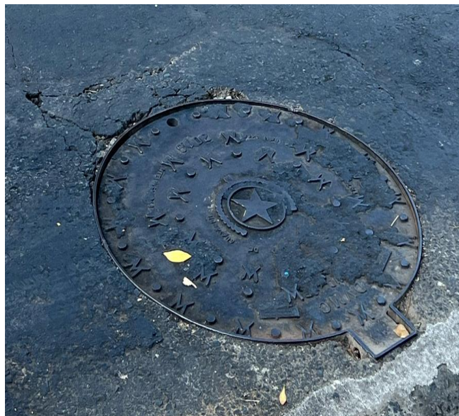
Figura 39. Tapa de Cámara de Inspección A20 Desnivel de la tapa alrededor de la capa de rodadura asfáltica y fisuras.
