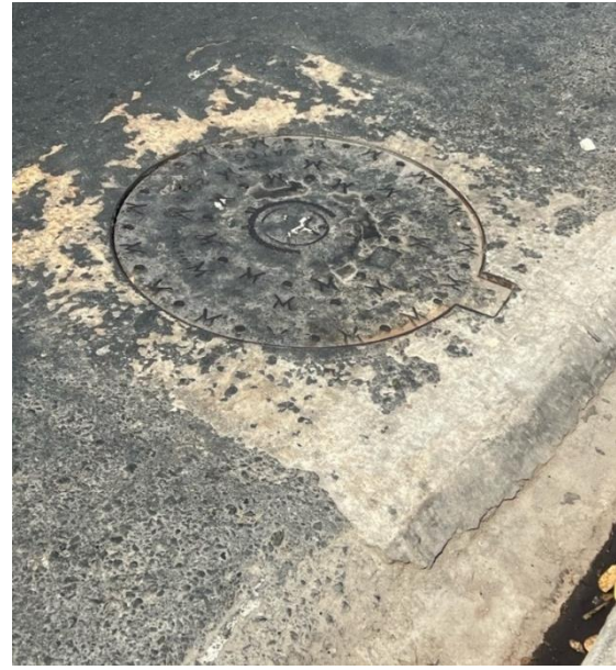
Figura 81. Tapa de Cámara de Inspección A62 Desnivel de la tapa alrededor de la capa de rodadura asfáltica
