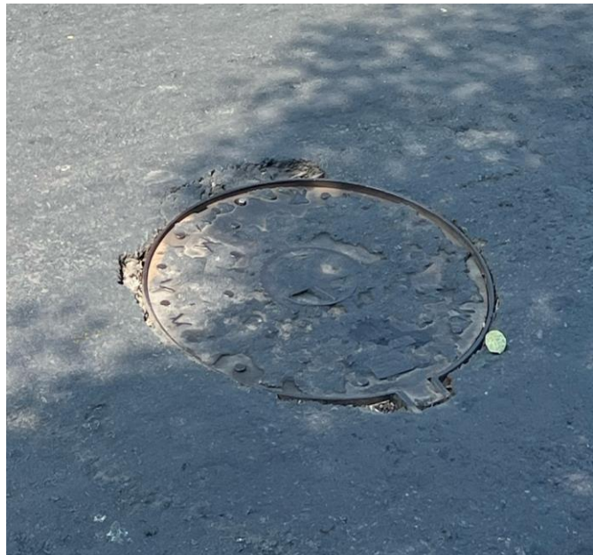
Figura 37. Tapa de Cámara de Inspección A18 Erosión y desnivel de la capa de rodadura asfáltica
