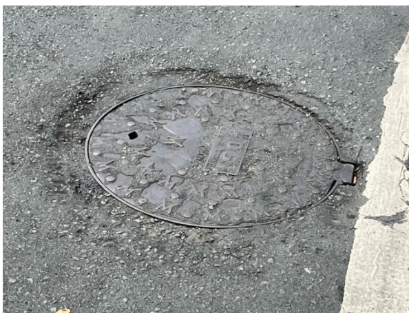
Figura 86. Tapa de Cámara de Inspección B1
