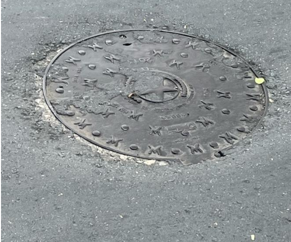
Figura 96. Tapa de Cámara de Inspección B11 Desnivel de la tapa alrededor de la capa de rodadura asfáltica
