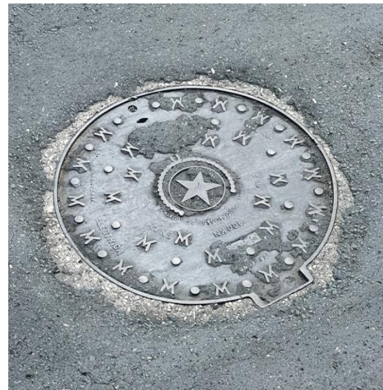
Figura 83. Tapa de Cámara de Inspección A64 Desnivel de la tapa alrededor de la capa de rodadura asfáltica
