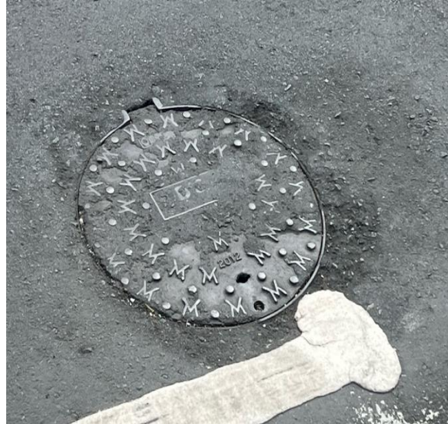
Figura 89. Tapa de Cámara de Inspección B4
