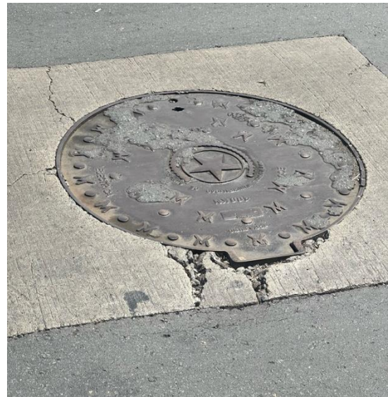
Figura 101. Tapa de Cámara de Inspección B16
