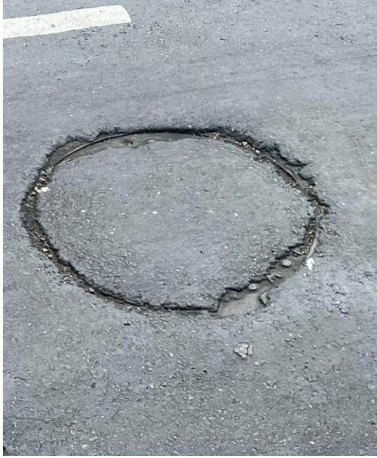
Figura 92. Tapa de Cámara de Inspección B7 Desnivel alrededor de la tapa y pérdida de carpeta asfáltica en fragmentos.
