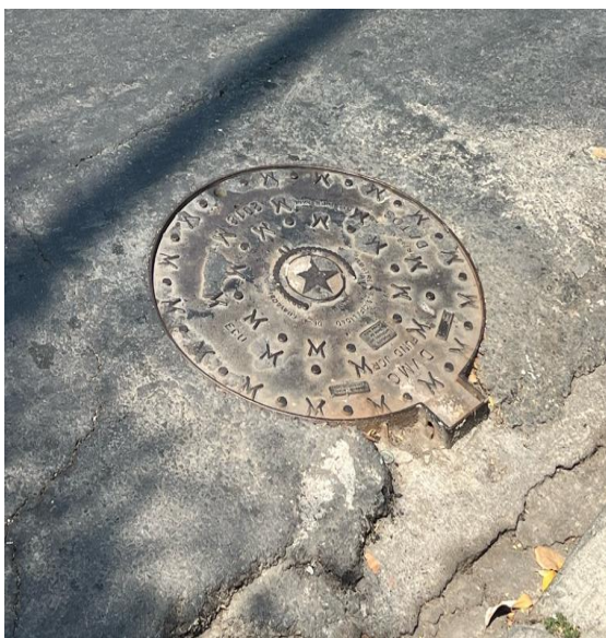
Figura 38. Tapa de Cámara de Inspección A19 Desnivel de la tapa alrededor de la capa de rodadura asfáltica
