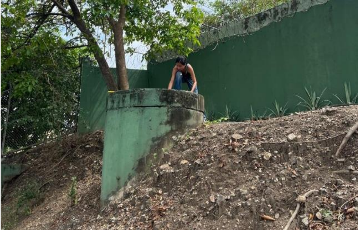
Figura 104. Cámara Sanitaria mal Integrada
