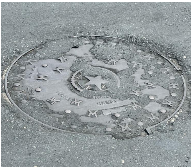
Figura 102. Tapa de Cámara de Inspección B17
