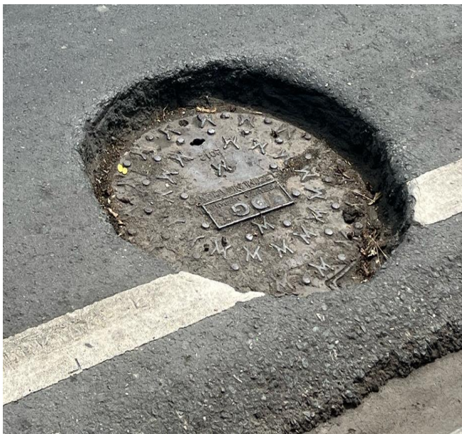
Figura 98. Tapa de Cámara de Inspección B13 Existe desgaste de la capa de rodadura asfáltica y desnivel.
