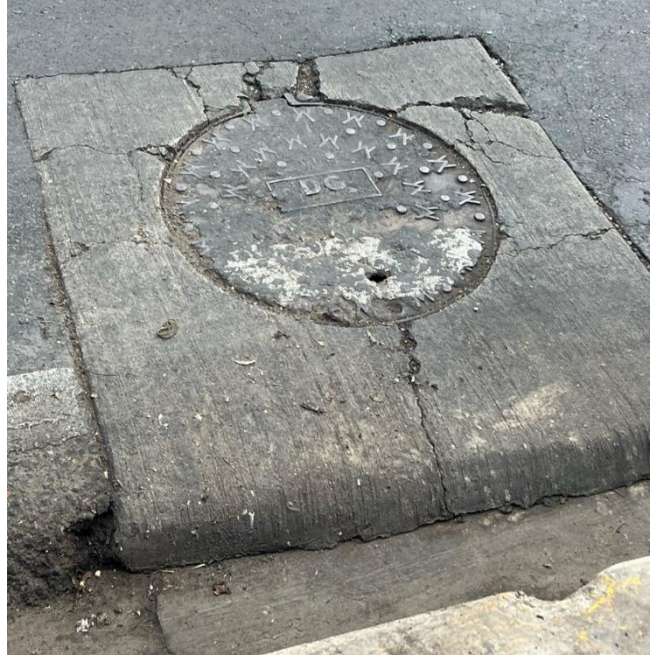
Figura 93. Tapa de Cámara de Inspección B8 Desnivel en la loseta de concreto y fisuras alrededor de la tapa.
