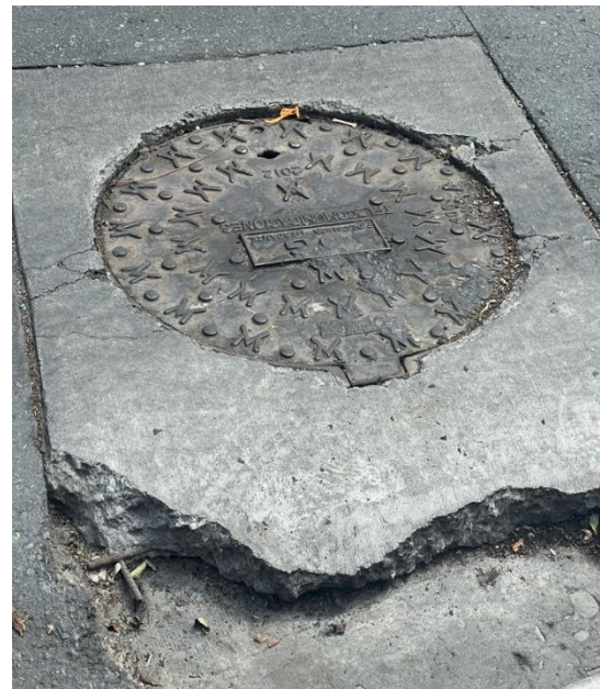
Figura 99. Tapa de Cámara de Inspección B14 Desnivel en la loseta de concreto y fisuras alrededor de la tapa.
