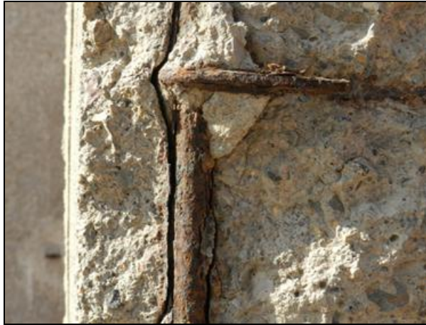
Ilustración 5. Evidencia de corrosión del refuerzo asociada a carbonatación y pérdida de alcalinidad del hormigón (ejemplo fotográfico). Alario Catalá (2014).
