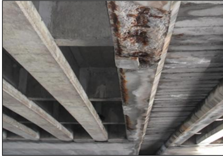
Ilustración 4. Manifestaciones típicas de corrosión inducida por cloruros en elemento de hormigón armado (ambiente marino–costero): manchas de óxido y deterioro del recubrimiento. (Magalhães, 2024).
