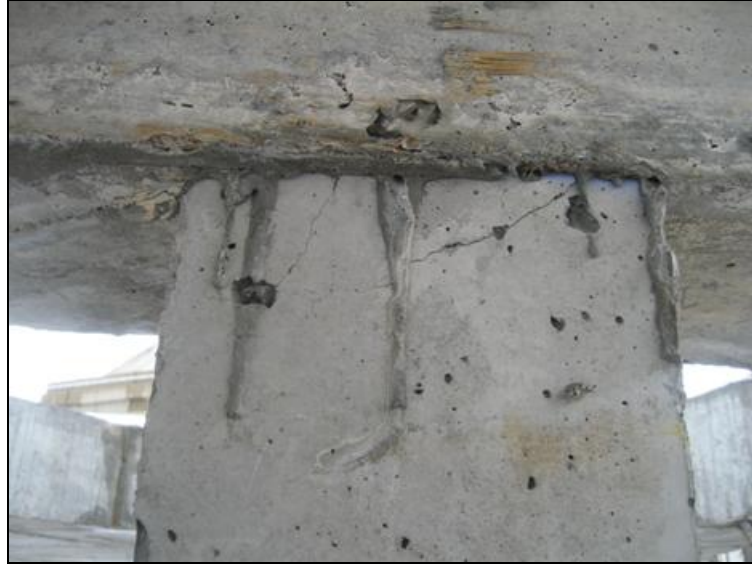
Ilustración 6. Fisuras y discontinuidades en elemento de hormigón armado como rutas preferenciales de ingreso de agentes agresivos. (Moreno, 2018).
