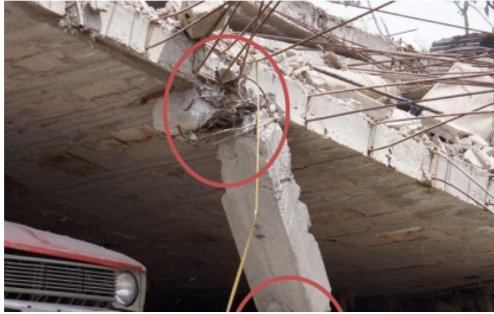
Figura 2.1b Daño en nudo, ocurrido en terremoto de Pedernales, de 16 de abril de 2016 (Díaz, 2016)
