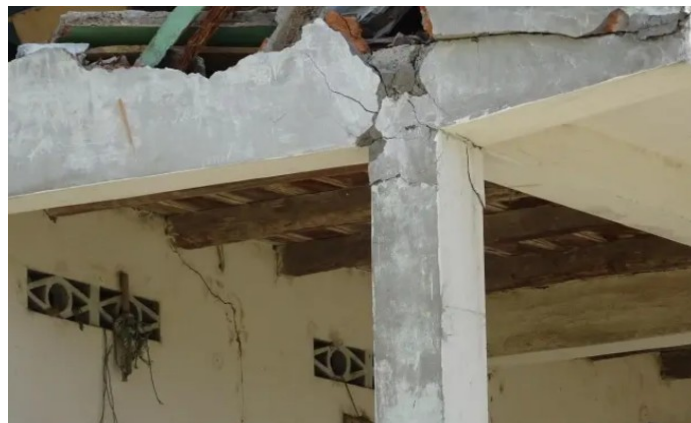
Figura 2.1a Daño en nudo, ocurrido en terremoto de Pedernales, de 16 de abril de 2016 (Díaz, 2016)
