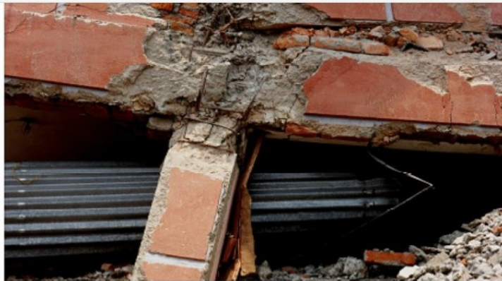
Figura 2.2 Falla en nudo viga columna, terremoto de Nepal, 2015 (Khokhar & Brzev, 2021)
