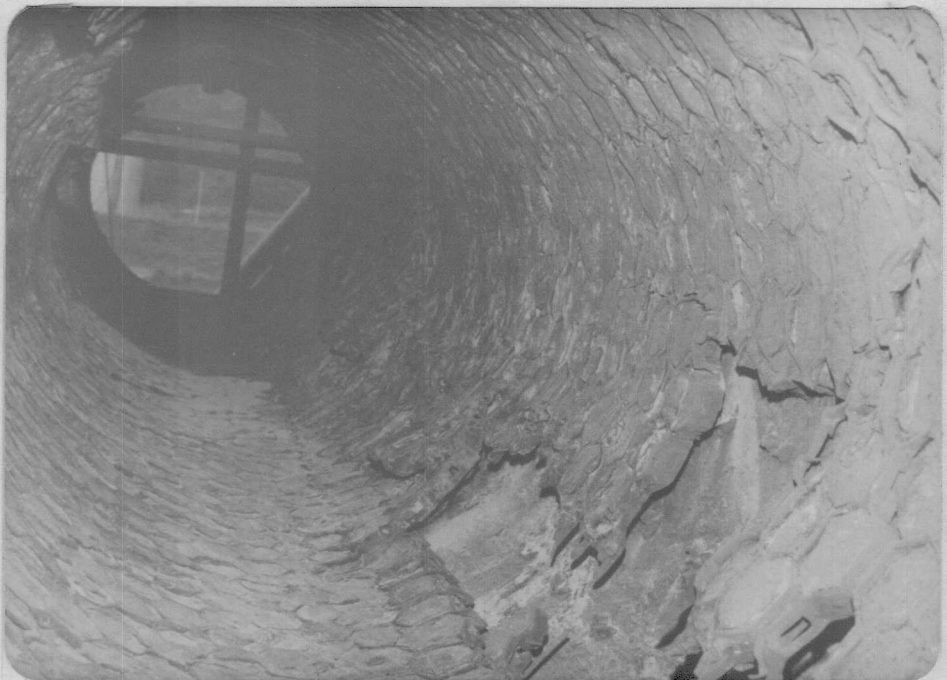
Vista interna de la sección superior del tubo elevador nótese la cantidad de malla exagonal y refractario caído
