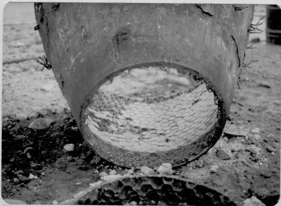
Vista de la parte del cono de la chimenea del regenerador. (nótese erosión y caída de refractario).
