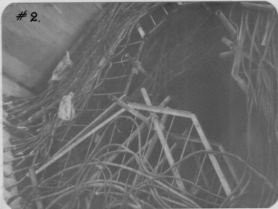
(Subestación, cables sumergidos en agua; foto. captada angulo superior. Fot. 2 lugar donde sucedió explosión Caseta 2).
