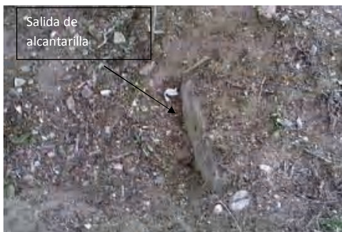
Figura 4.2 Alcantarilla tapada con sedimentos
