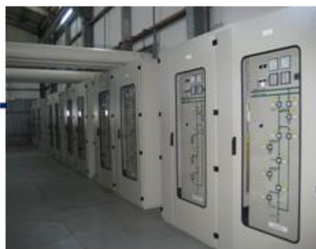
Fig. 41b. Tableros de control local.
