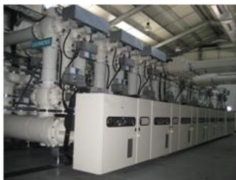
Fig. 41a. Equipo de Alta Tensión
