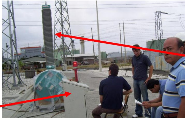
Fig 22. Equipo de prueba de Alta Tensión.
