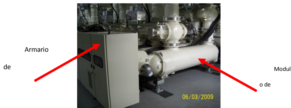
Fig. 8. Interruptor de potencia
