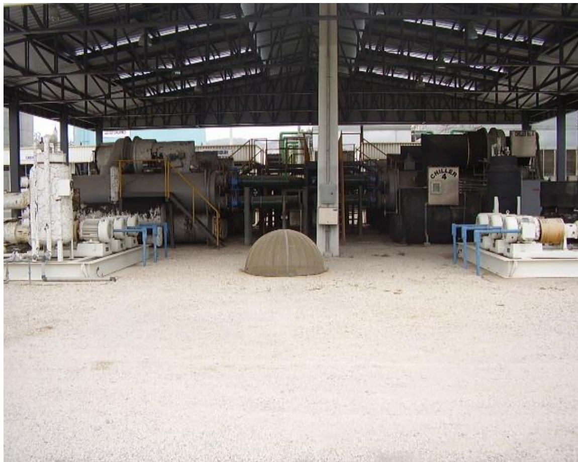
FIGURA G.2 SISTEMA CHILLERS PARA ENFRIAMIENTO DE LA TURBINA
