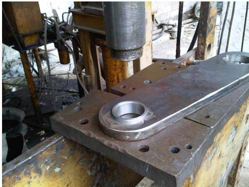
Figura A.14 Los cojinetes de deslizamiento se insertaron con ayuda de una prensa hidráulica
