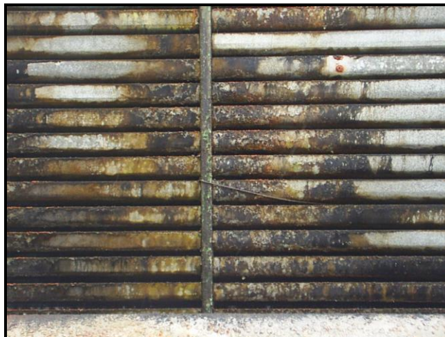
FIGURA 1.8. BARAJAS CORROÍDAS DE LA TORRE
