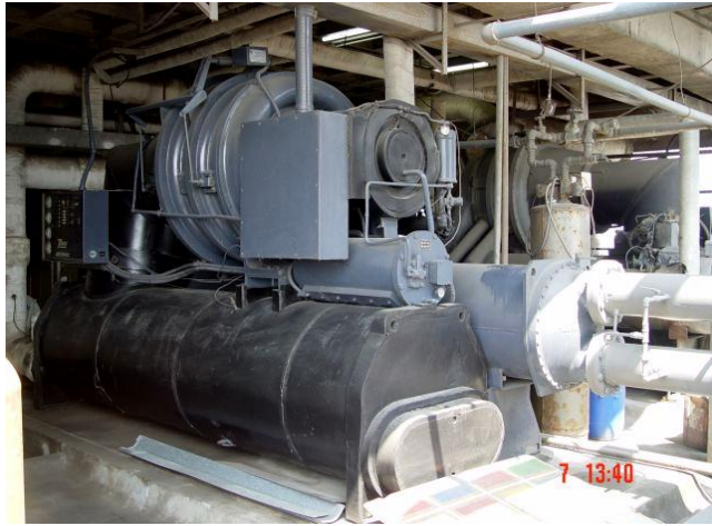
Figura 1.3. CHILLER CENTRAVAC MARCA TRANE
