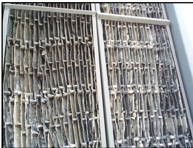
FIGURA 1.9. PANELES DE PVC EN MAL ESTADO
