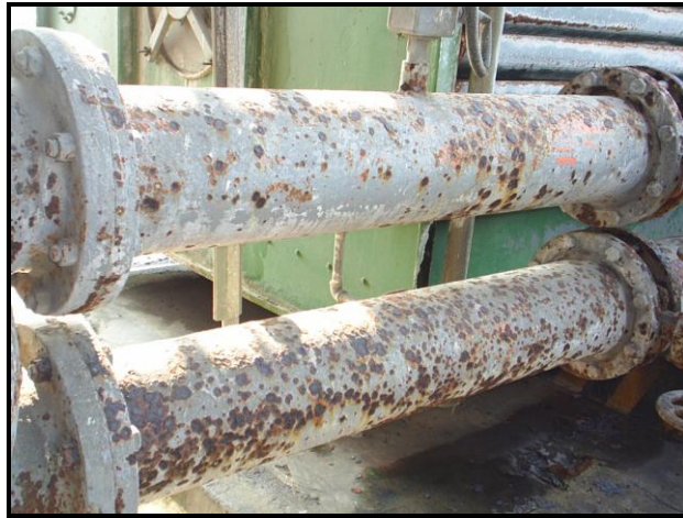
FIGURA 1.7. TUBERÍAS CORROÍDAS SISTEMA CHILLER-BOMBA-TORRE
