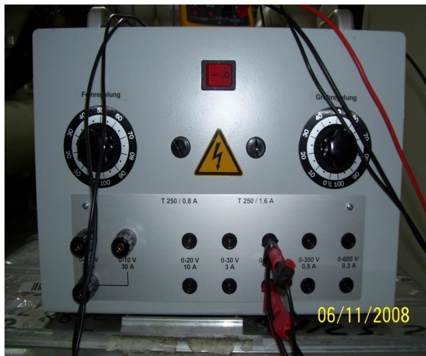
Fig 20. Equipo de Inyección de corriente.
