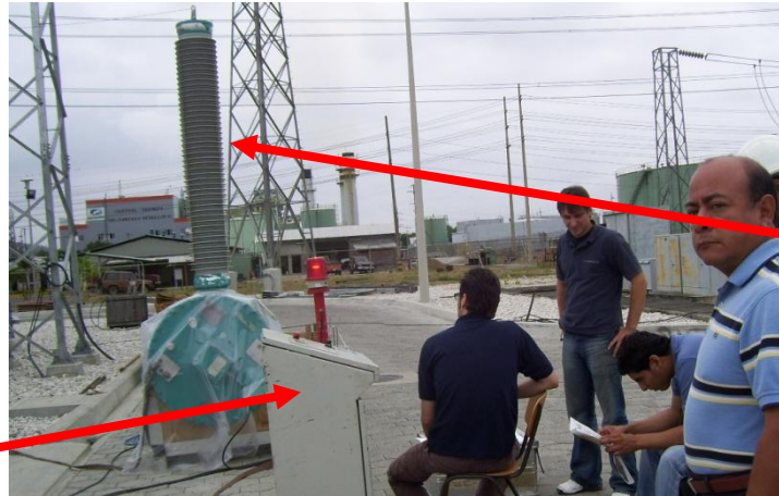
Fig 22. Equipo de prueba de Alta Tensión.
