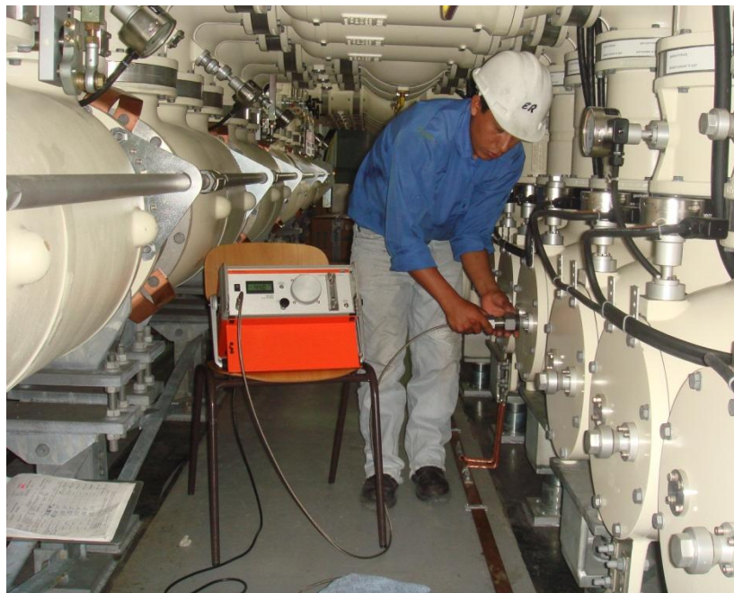
Fig 29. Equipo de medición de punto de rocío.
