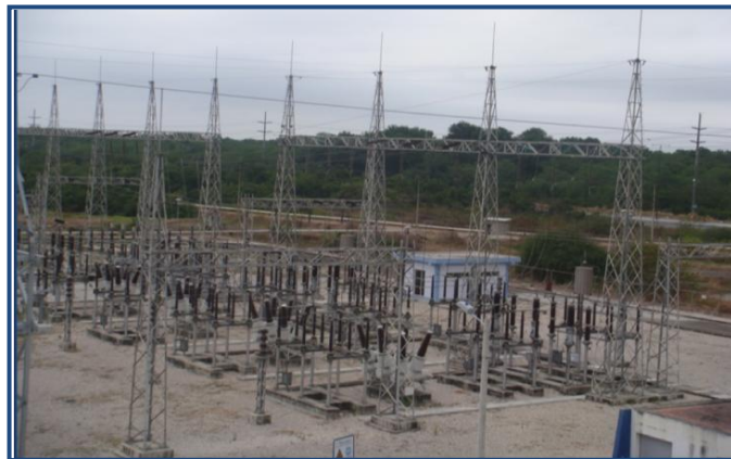
Fig 4. Patio de 138KV (Convencional)
