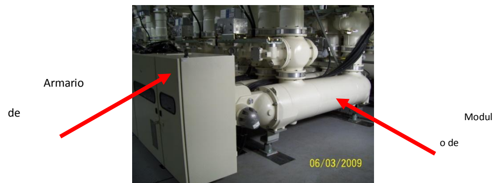
Fig. 8. Interruptor de potencia
