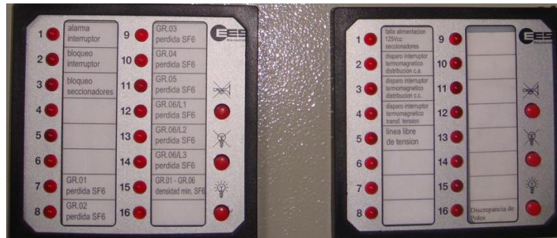
Fig 30. Panel de alarmas del Nivel Cero
