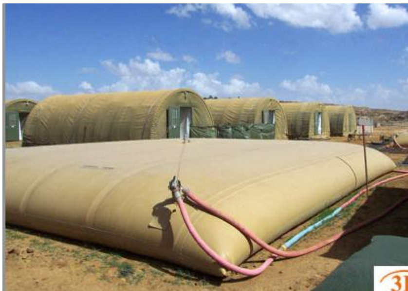
FIGURA 2.14. TANQUE DE ALMACENAMIENTO
