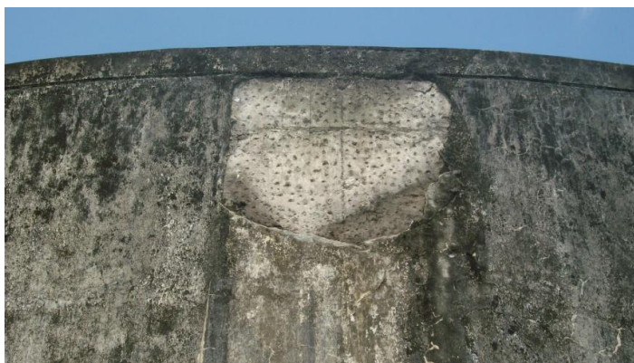
Deterioro del reservorio
