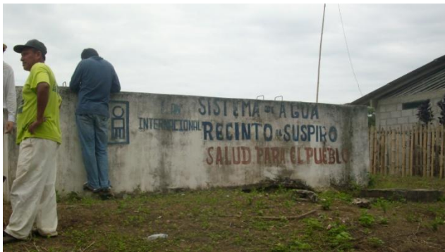
Reservorio del comité del sistema de agua “El Suspiro”, el Suspiro
