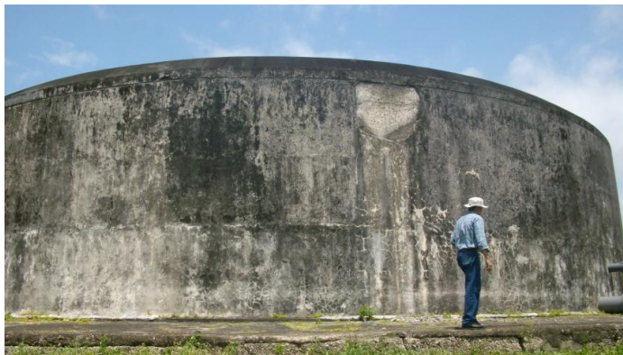
Reservorio de la Junta administradora del a agua "Valdivia", Carrizal
