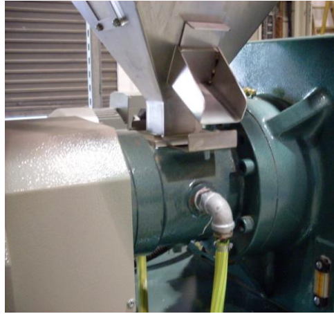
FIGURA 3.21 Refrigeración con agua
