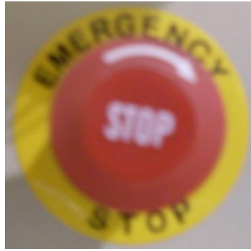
FIGURA 3.9 Paro de Emergencia
