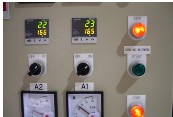
FIGURA 3.12 Termómetro y Botones de encendido del calentador C1 y C2; Botón de encendido y apagado del Blower
