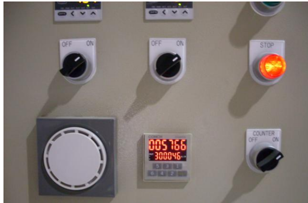
FIGURA 3.14 Botones de encendido del calentador A1 y A2; Contador
