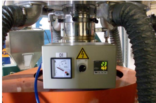
FIGURA 3.25 Resistencias, Termocuplas, Monitores
