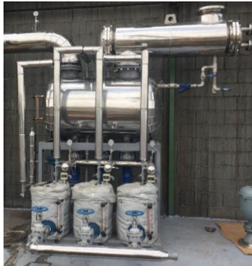
Figura. Nuevo sistema de recuperación de condensado
