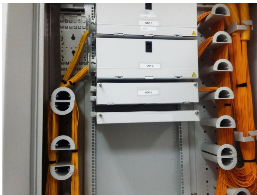
Figura 3.8: Rack de Planta Interna en Central Telefónica Daule
