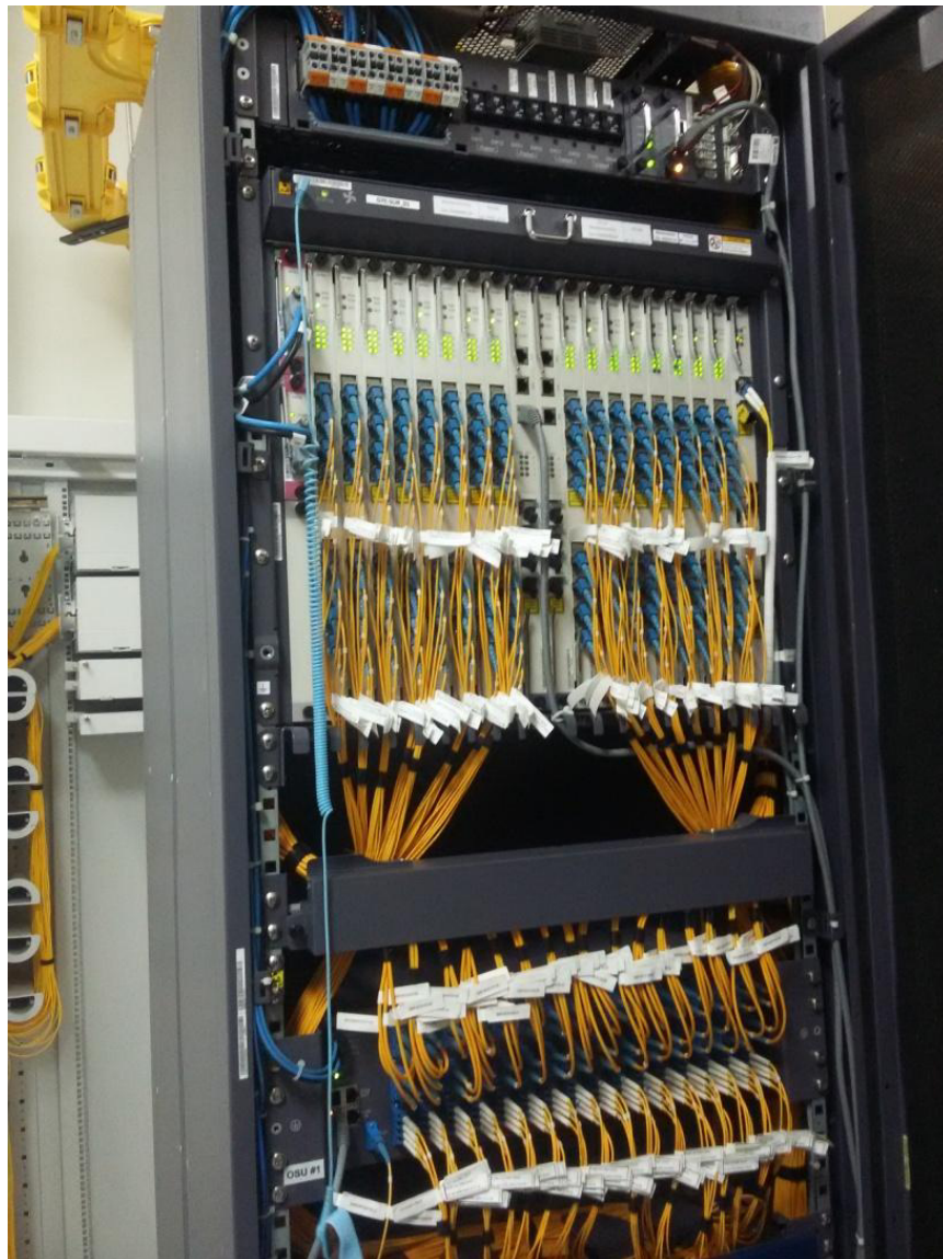
Figura 3.6: Rack OLT existente
