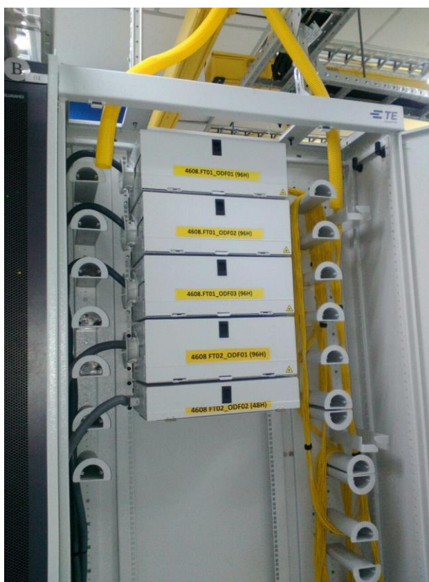
Figura 3.9: Rack de Planta Externa en central telefónica Daule
