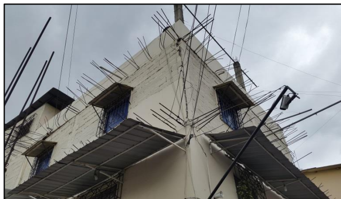
Figura 3.2: Varillas de hierros sobresalidos.
